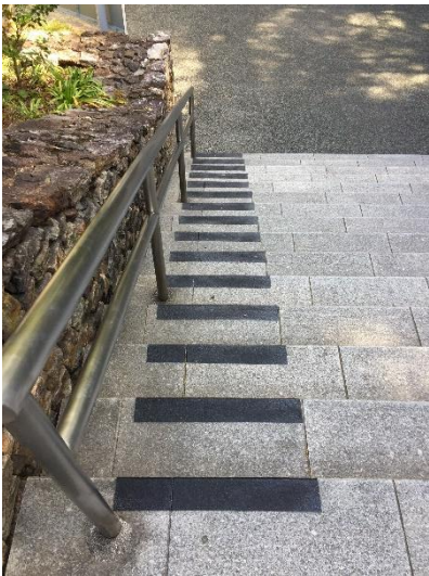
図.11 バリアフリーの再確認。階段に滑り止め塗装しコントラストを改善した。
